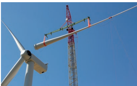
Une phase spectaculaire du montage : la levée de la dernière pale sur son moyeu.
